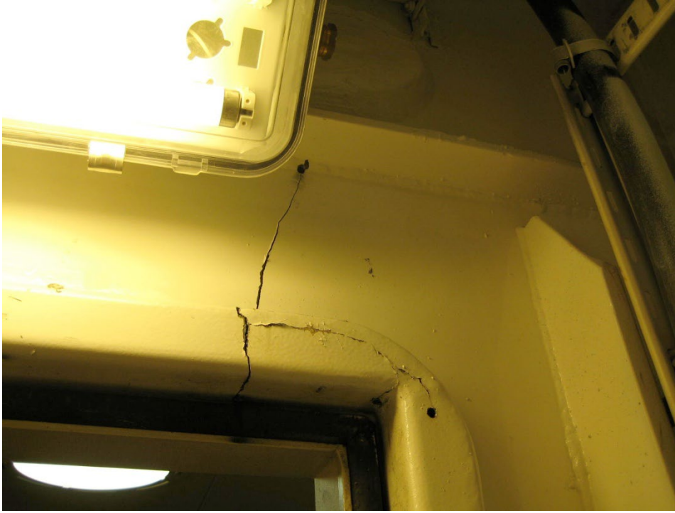
Şekil 2.1 Boyuna perdedeki açıklıklar – kapı çerçevesi civarındaki bir çatlak
